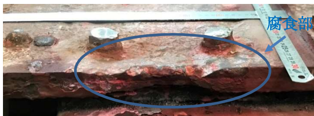
写真-1 ガセット取り付け部の腐食状況(e-e 断面)
