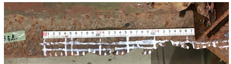
写真 4 下フランジ腐食欠損状況（上流側）
