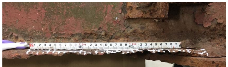
写真 3 下フランジ腐食欠損状況（上流側）
