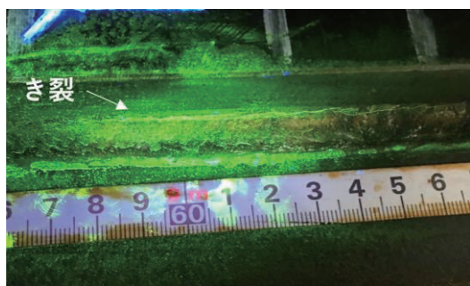
写真4 疲労き裂 (A3, N=304万回)
